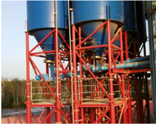
Siloanlage mit SHA Förderschnecken
