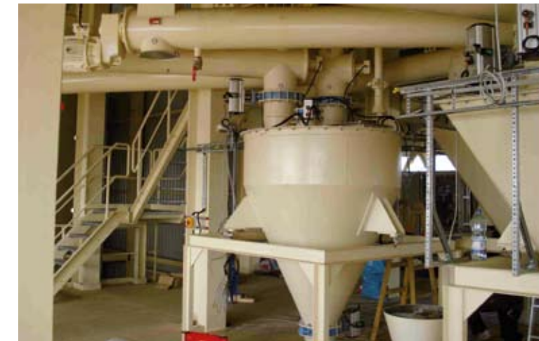
„Red Line“ Rohrförderschnecken im Trockenmörtelwerk
