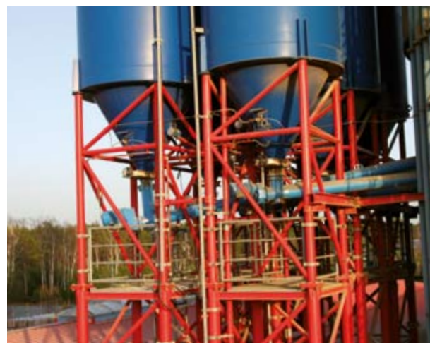
Siloanlage mit SHA Förderschnecken
